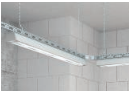
Применение усиленных кабельных лотков для монтажа светильников
